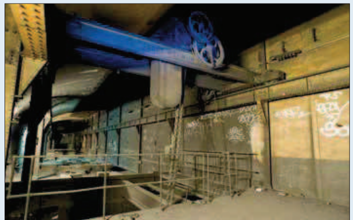
Die seit Jahrzehnten unbenutzten Gewölbe einer ehemaligen Trafostation. © Foto: Harald A. Jahn
